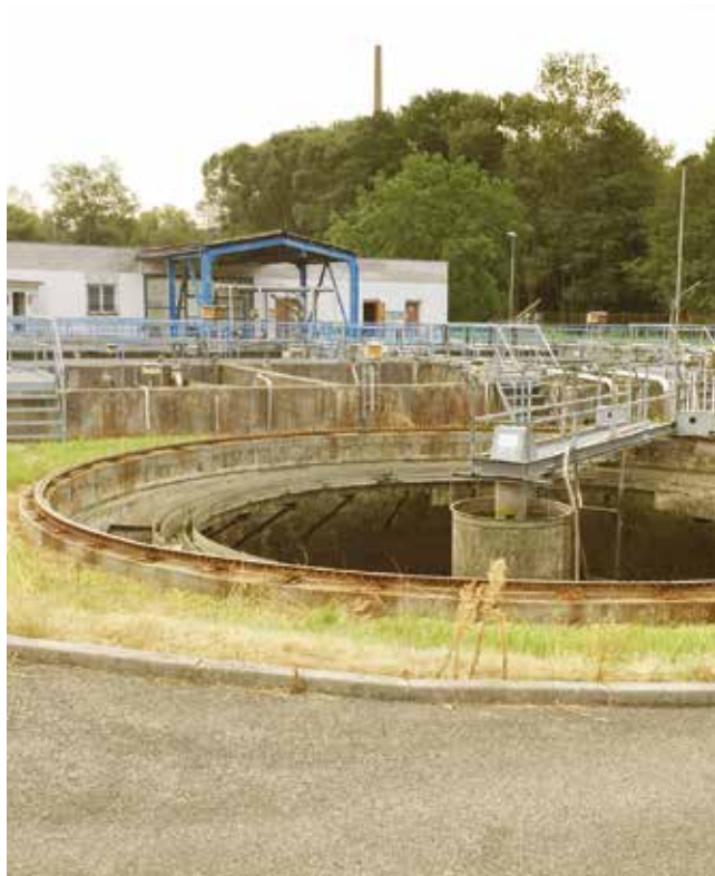
Čistírna odpadních vod Nové Město pod Smrkem
